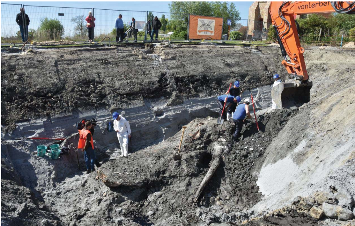
Figuur 46. Na een dag graven worden de contouren van Potvis Valentijn zichtbaar (13 mei 2019).
