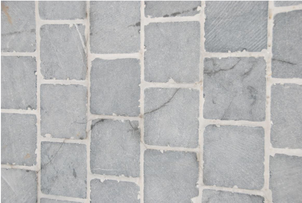
Figuur 5. Overzicht op een deel van de oprit met gebarsten platines die oplijnen van links onder naar rechts boven, herkenbaar aan de donkere lijnen, met ook breukjes in de voegmortel. Dit wijst op breuk na extra belasting door voertuigen volgens vooraf bestaande zwaktezones.
