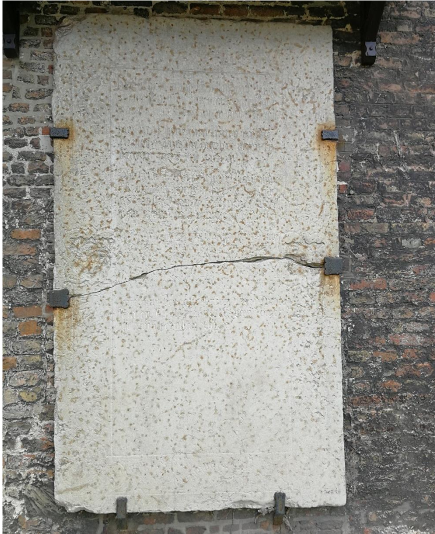
Roestig gevlekte Gotland kalksteen langs de noordgevel van de St.-Gilliskerk.
